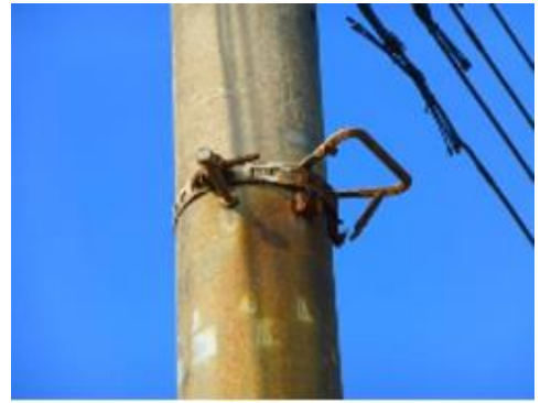
腐食により欠損している例
