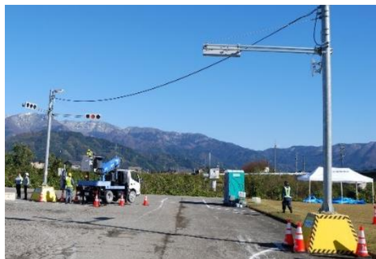
設置した仮設信号機
